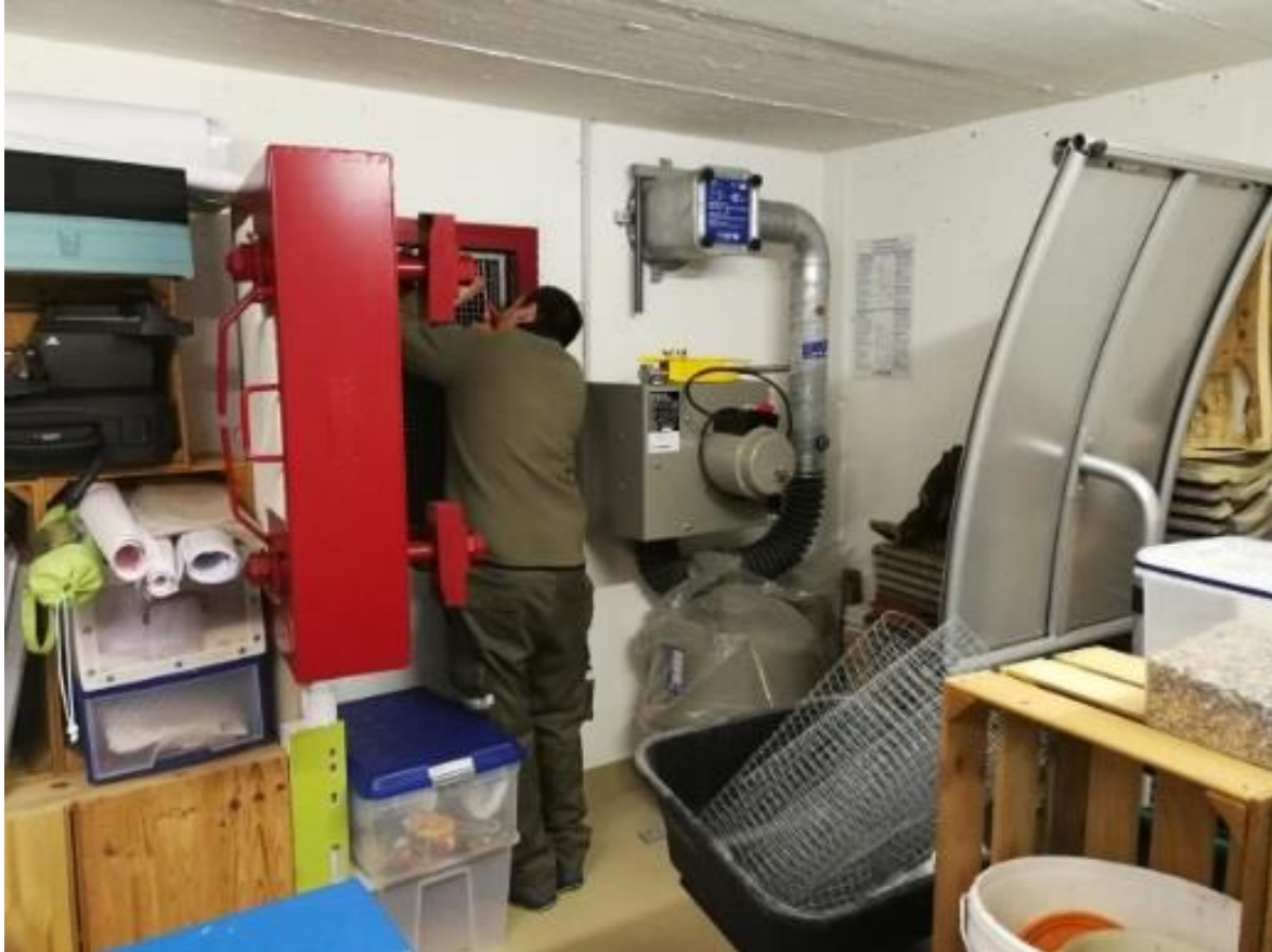
Zivilschützer beim Entfernen des Sicherheitsgitters, damit die Anlage getestet werden kann
