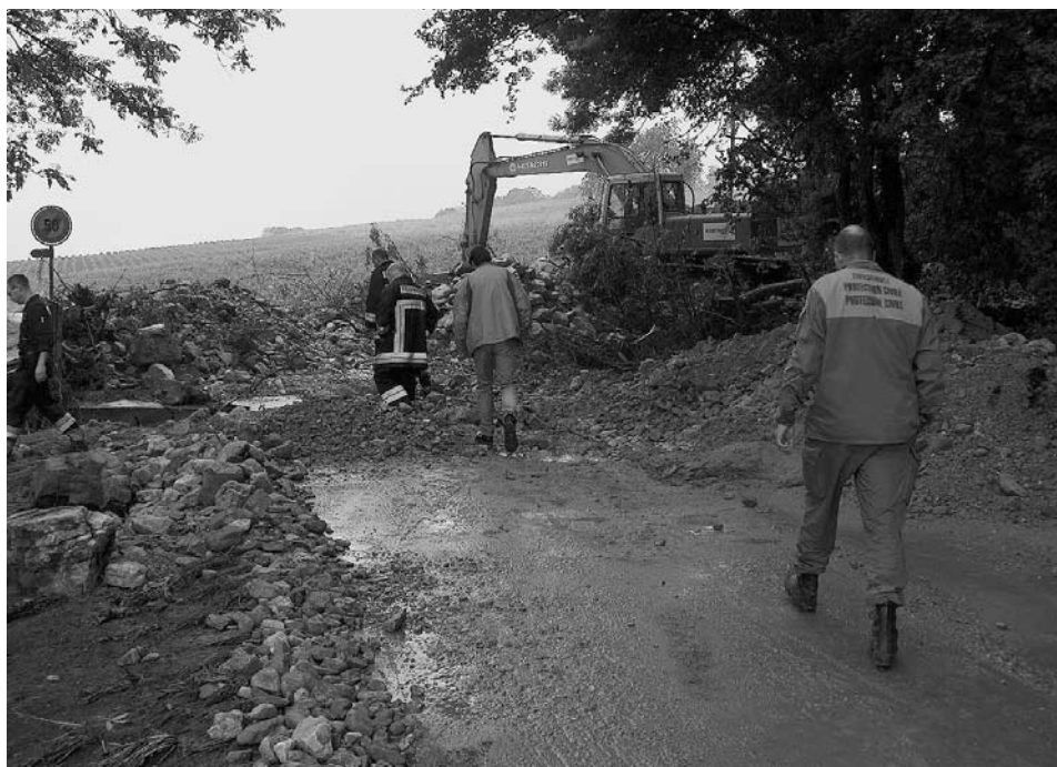
Die Säuberung des Bachbeet ist wichtig, damit der Bach nicht mehr durch die Häuser fliesst
